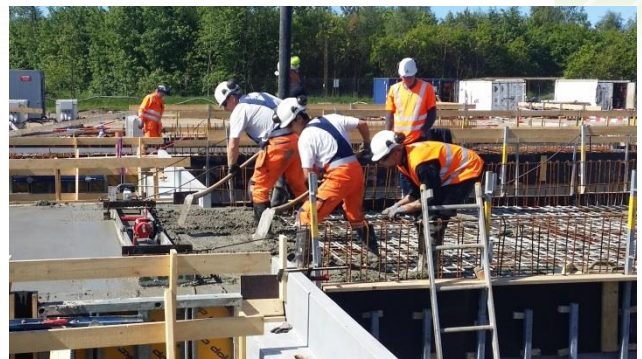
Entreprenører i færd med den sidste pladestøbning på den 1.200 m 2 store Bygning 6, der blandt andet rummer modtagefaciliteterne til husdyrgødning, energiafgrøder og affald.
